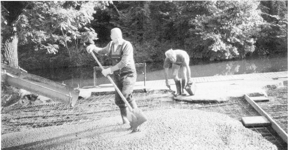
Eigenarbeit: Hans Falk und Eckard Schulz betonieren den Platz zwischen Bootshaus und Bootssteg neu
