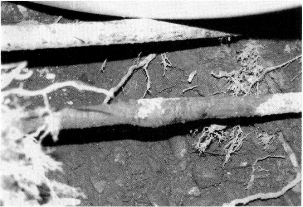
So sehen Rohre nach 70 Jahren aus. (dunkel = Nässe!)
